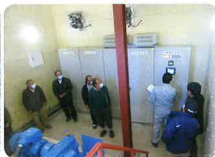
大間々用水神梅発電所内部
