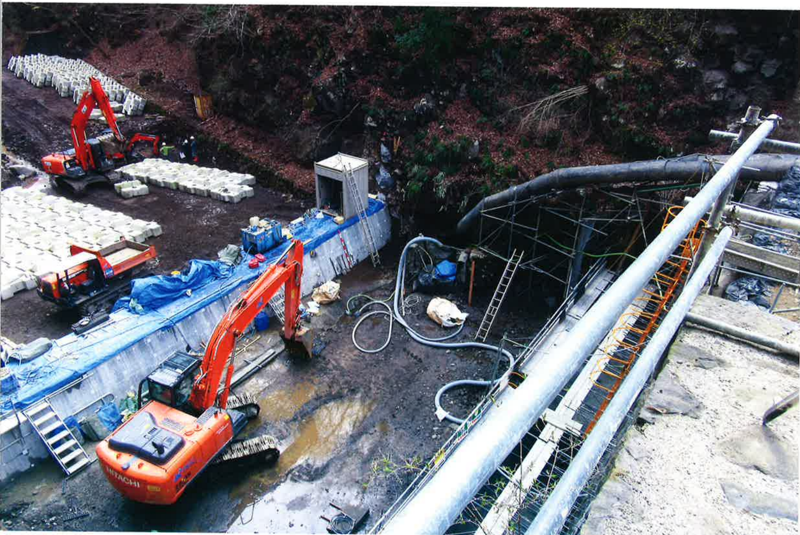
～完成間近の深沢川頭首工～ 令和元年度の工事状況。出水時の取水ゲート操作が可能となります。
